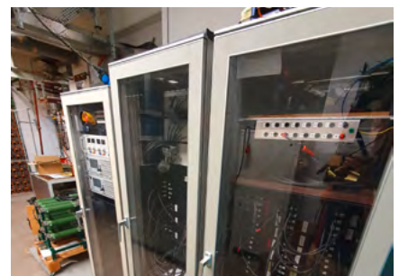
LVDC-SCHALTSCHRÄNKE MIT PASSIVEN LASTEN & GESTEUERTEN SPANNUNGSQUELLEN
