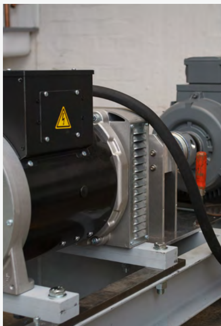
30 kW GEKOPPELTER MASCHINENSATZ (ASYNCHRONMASCHINE UND SYNCHRONMASCHINE)
