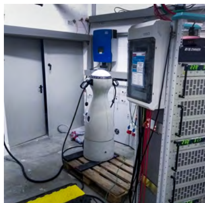
Abbildung 1: Ladesäule der PION AG im 7-stündigen 44kW-Dauerbelastungstest
