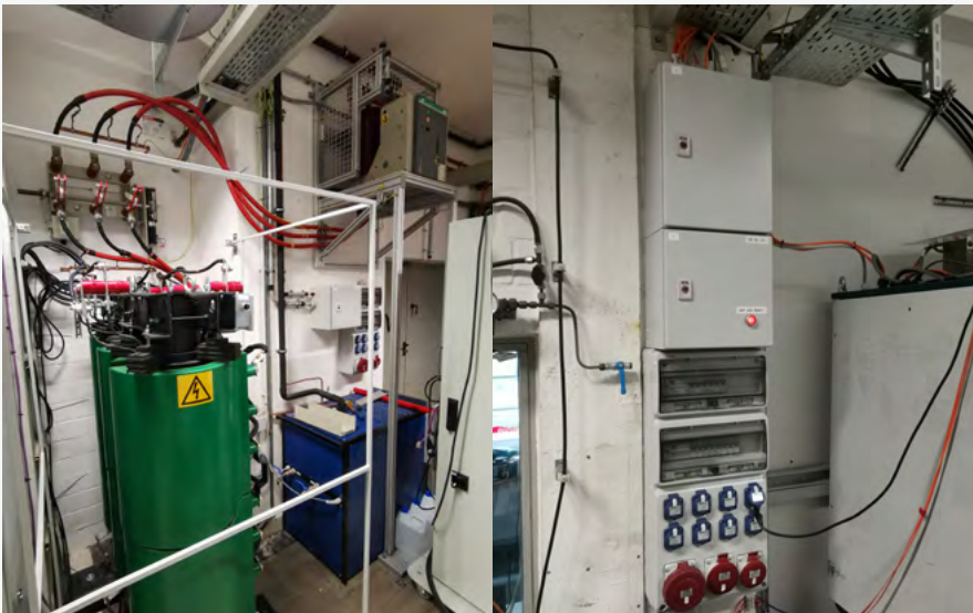
6KV Versorgung mit zwei Sicherheitskreisen und der Ansteuerung eines Draufschalters, eines Sicherheitstrenners, eines Erdungstrennschalters sowie eines Lasttrennschalters Projekt SMS2
