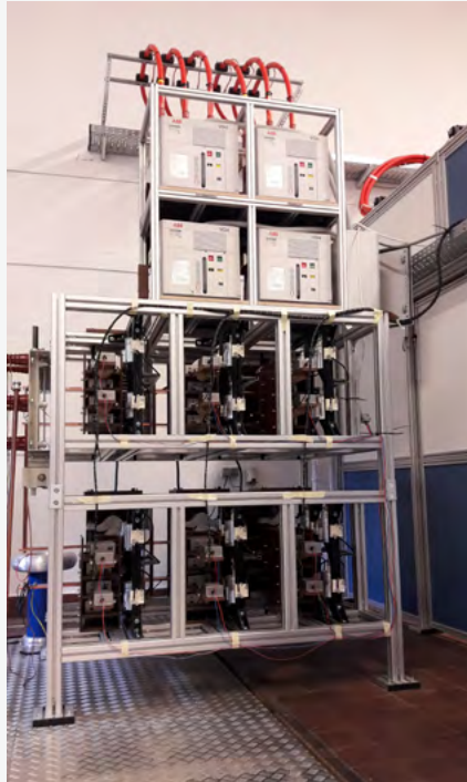
B12 GLEICHRICHTER INKLUSIVE VORGELAGERTER LEISTUNGSSCHALTER
