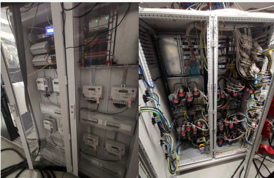
Zählermessschrank zu Entwicklung von Messverfahren für Mehrfachnutzung von PV-Heimspeichersystemen bis 70kW Leistung Projekt MELANI
