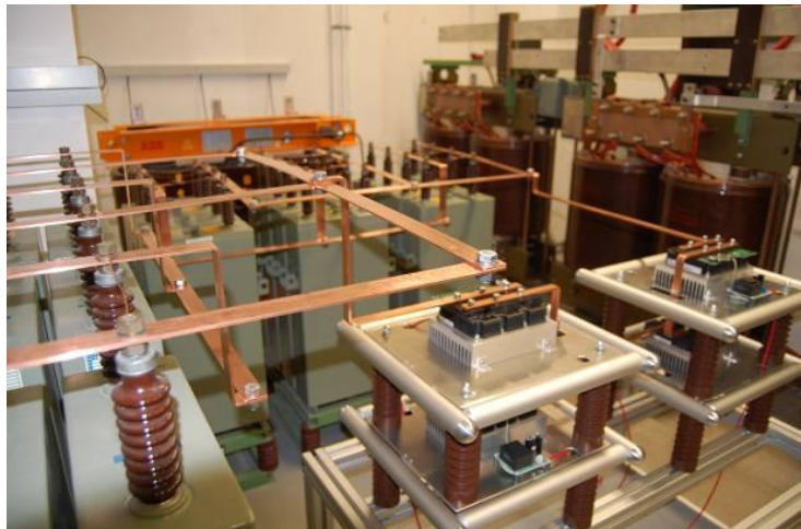
Abbildung 2: Erweiterte HGÜ-Prüfanlage am elenia
