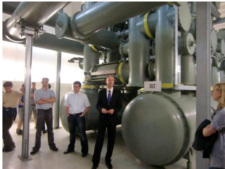
Abbildung 1: Gasisolierte Schaltanlage 380 kV im Umspannwerk von EnBW
