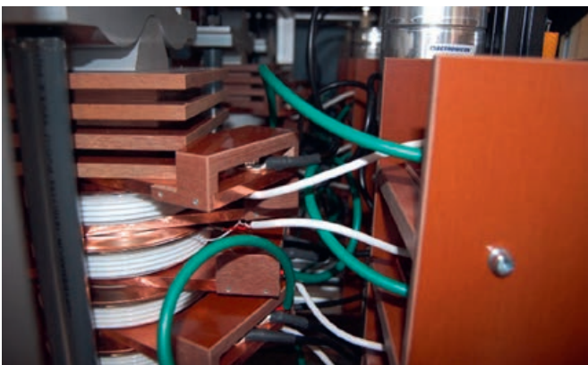
↓ Isolation der Thyristoren einer B12Brücke
