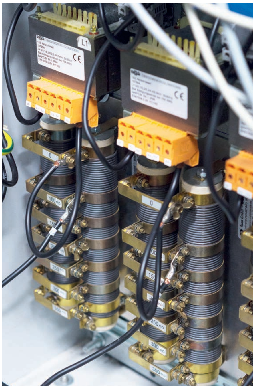
Abbildung 6: Leitungsnachbildende Elemente entsprechen bis zu 1,8 km Niederspannungskabel
